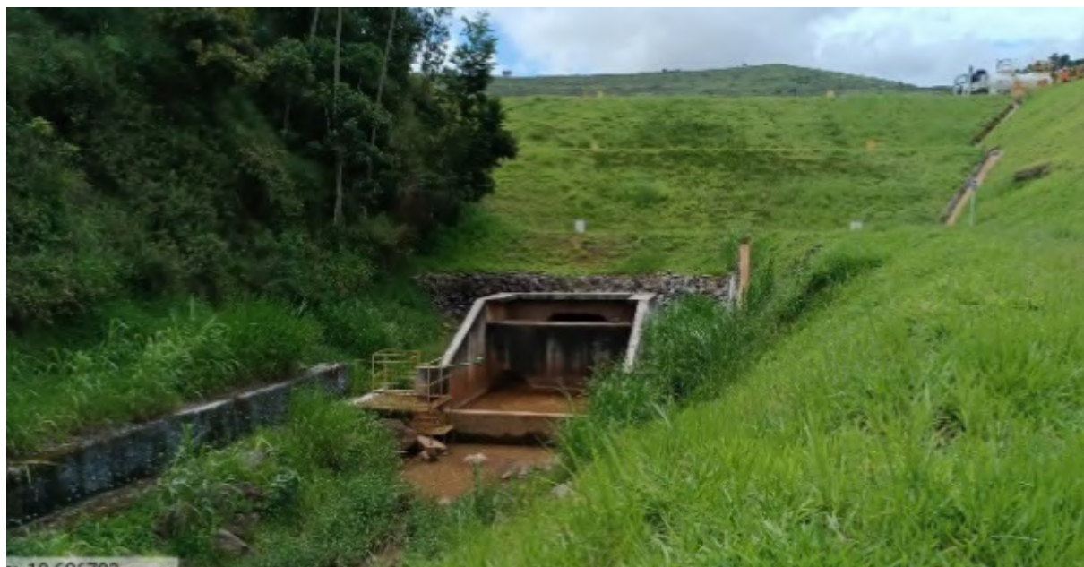
Poço de tomada d'água (tulipa) e saída da galeria do sistema extravasor da barragem Quinzinho nas condições anteriores à implantação do sistema do vertedouro de soleira livre.
