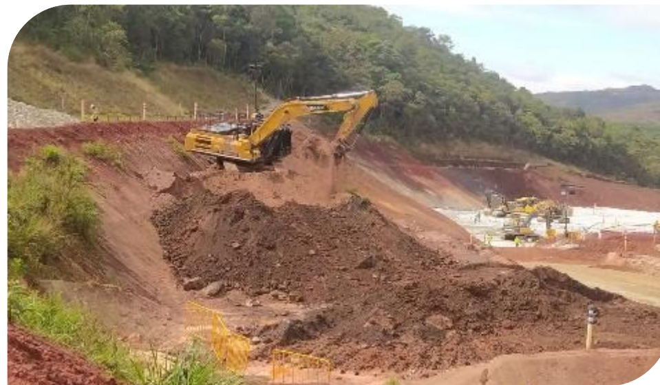
Registro das atividades de terraplenagem na ombreira esquerda Fonte: Meio Ambiente CSL –BJP
