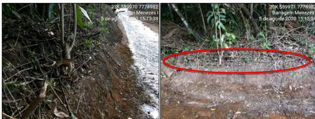
Figura 4-26 – Armação aparente “01”, observada em trechos do extravasor.
