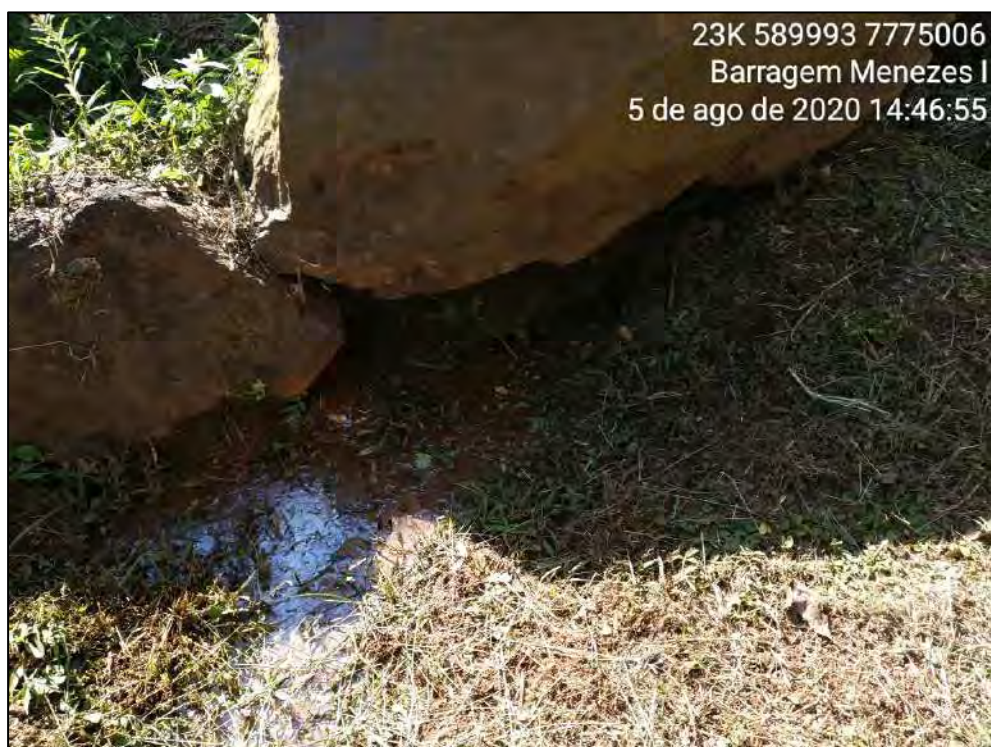
Figura 4-33 – Sedimento ferruginoso com aspecto oleoso saindo no dreno de fundo, pé da barragem.
