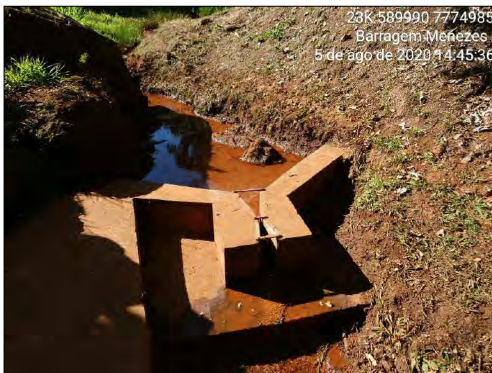
Figura 4-30 – Medidor de vazão da drenagem interna, visto de jusante.
