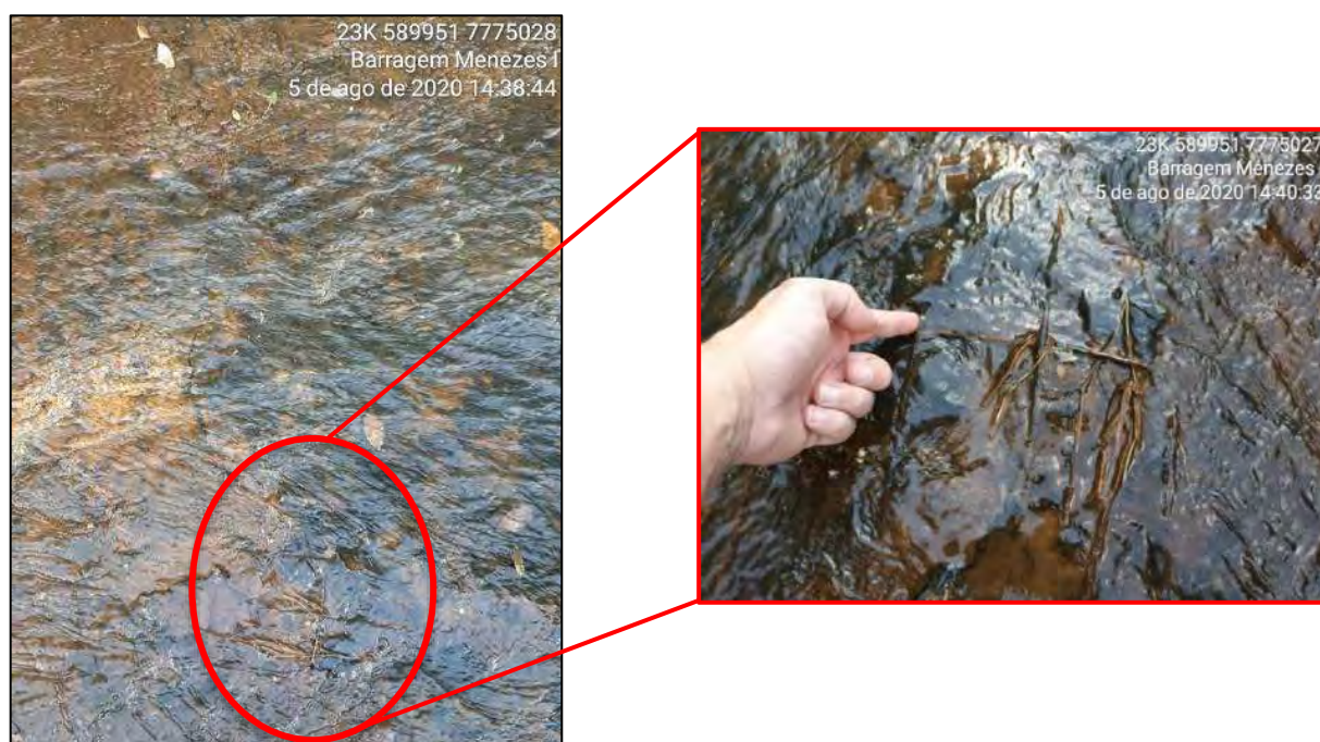
Figura 4-27 – Armação aparente “02” observada em trechos do extravasor.
