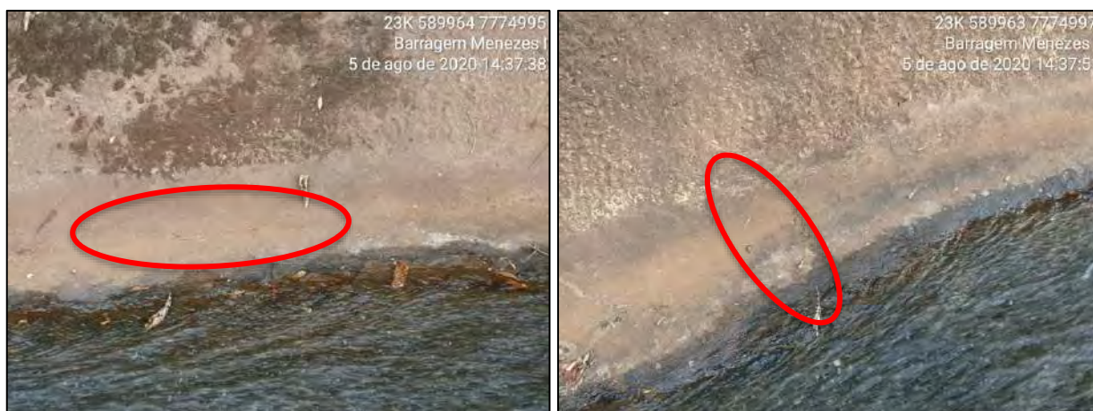
Figura 4-24 – Trincas/fissuras “03”, observadas ao longo do extravasor.
