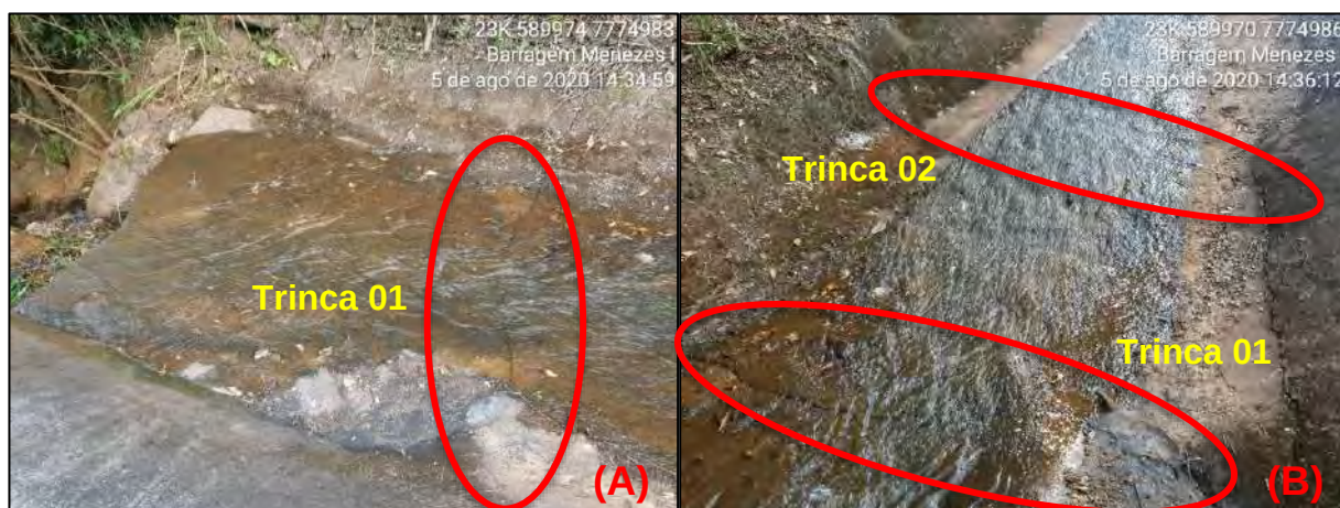
Figura 4-23 – (A)Trinca “01”, no trecho mais a jusante do extravasor. (B) Trinças “01” e “02”.
